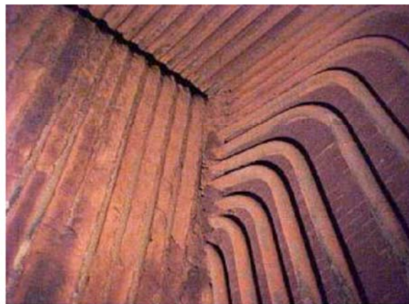
شکل 13-5- دیواره جوش آور، لوله‌های در معرض شعله
